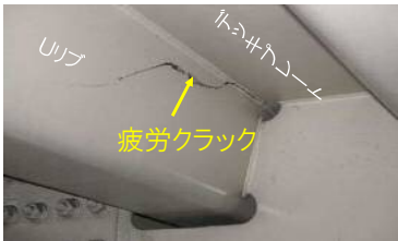
鋼床版の変状
