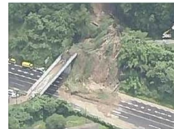
①【鹿児島県】九州自動車道 被災状況
